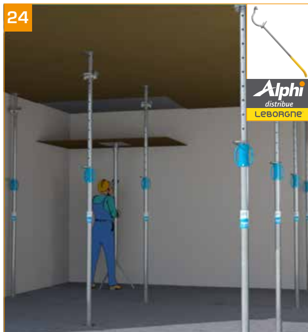
- Décoffrage de la dalle : enlever les étais placés en périphérie des cellules. - Laisser en place pendant 3 jours minimum les autres étais (selon type de béton et température extérieure). - Utiliser un lève-plaque pour retirer le CP.
